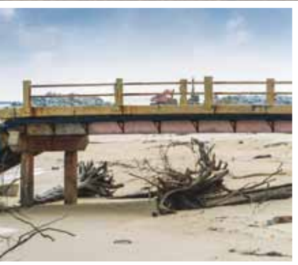
menyebabkan hakisan berskala besar di Telipot terus menimbulkan kebimbangan dan masyarakat sekitar. Dalam masa ombak besar telah mengakibatkan kerosakan di sepanjang pantai UMT dalam tempoh berturut-turut.
